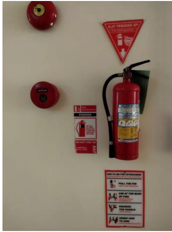
Gambar 23. Alat Pemadam Kebakaran (Sumber : Dokumentasi Pribadi)
